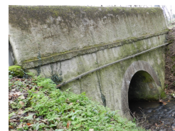
H : Entrefin route Adriers-Plaisance
